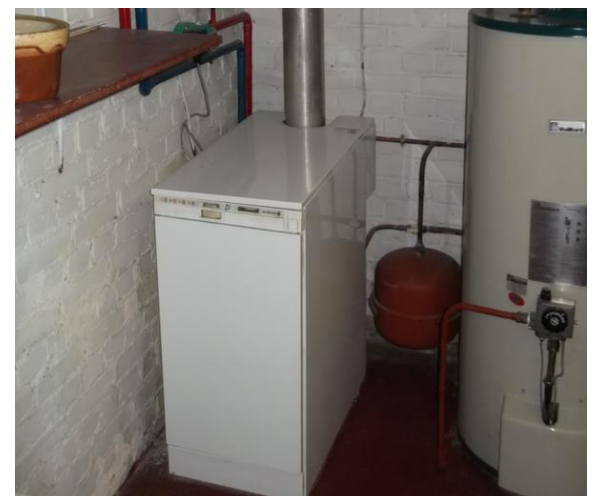
L'ancienne chaudière, vieille de 35-40 ans. « C'était des frais dessus tous les ans », déplore Marceau Thellier.
